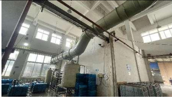
废气收集管道
